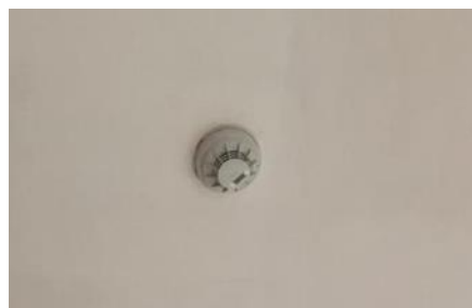
Gambar 5 smoke detector di rumah sakit
