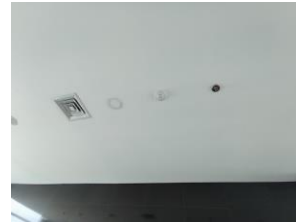
Gambar 10. Smoke Detektor dan Sprinkler
