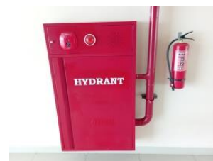
Gambar 8. Hidran Gedung dan APAR
